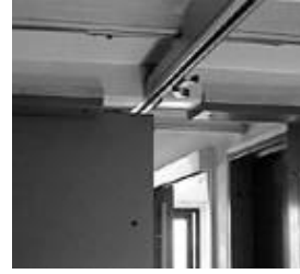
Transito attraverso una porta scorrevole
